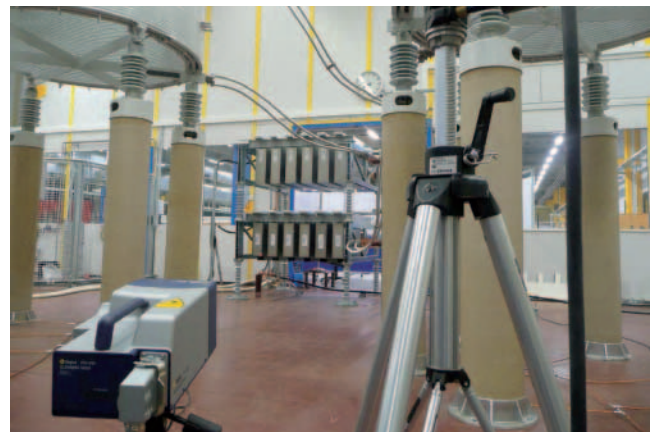
Bild 2: HVDC-Versuchsanlage, Messaufbau für die Rückseite
